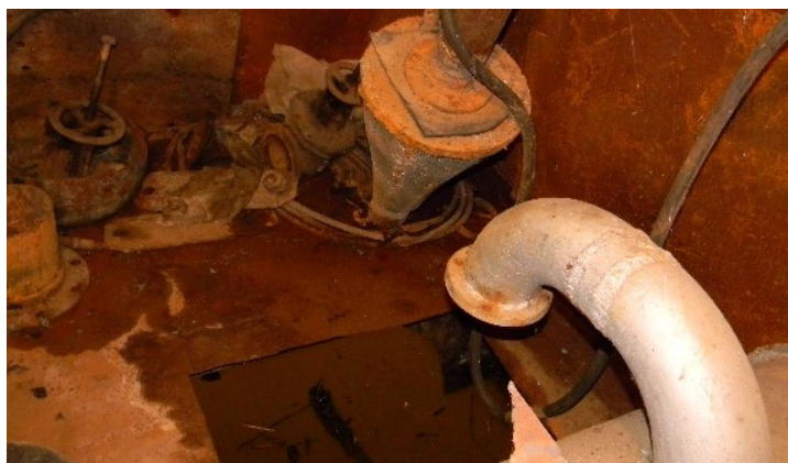
Рис. 4. Техническое состояние водозаборного устройства и насосной станции первого подъема
