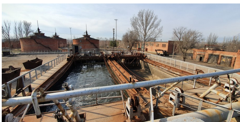
Рис. 6. Горизонтальная песколовка Северных очистных сооружений канализации
