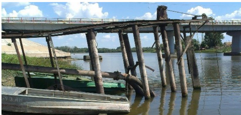
Рис. 3. Водозаборное сооружение (всасывающие трубопроводы на деревянных опорах)
