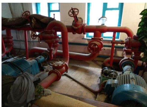
Рис. 2. Насосная станция завода ООО «Астраханский Рис»
