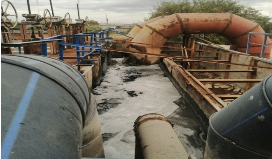
Рис. 1. Приемная камера Южных очистных сооружений
