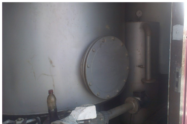
Рис. 2. Крайне ограниченное внутреннее пространство модульной водоочистной станции типа «Исток»
